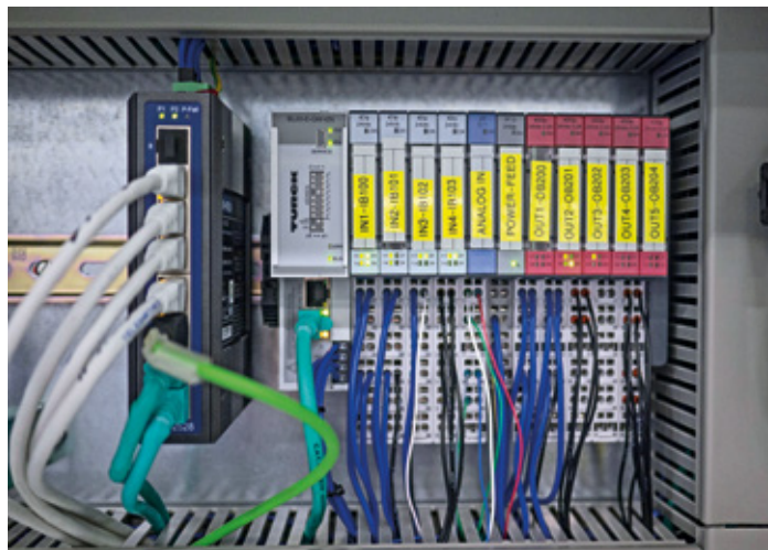
Die zentrale BL20-I/O-Station sitzt an der Zentralschmieranlage und gibt alle Signale über Profinet an das HMI TX513 weiter
